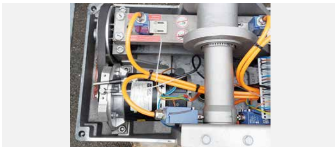
Abb. 2: Messungen mit dem Mikrofon und dem Beschleunigungssensor am Motor der Barriere des Industriepartners.
