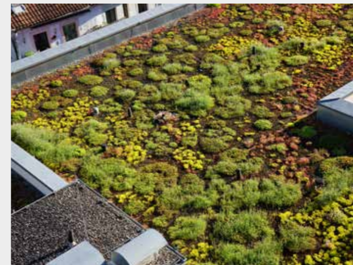
Abb. 12: extensives Gründach (© AdobeStock)
