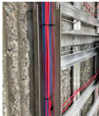
Abb. 63: Kabelkanäle aus feuerfestem Metall (Stahl verzinkt oder CNS) und vertikale Schienen der Unterkonstruktion, auf welchen die Module befestigt werden. Die Kabelkanäle dienen auch zur Brandabschottung (© Silvia Domingo Irigoyen)
